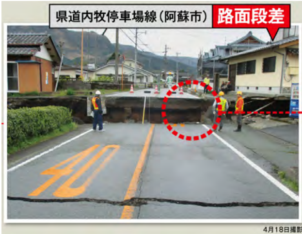
図 35 阿蘇市の道路支障箇所
