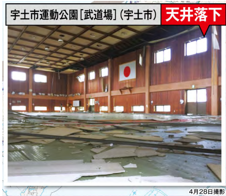
図 25 公共施設の損傷事例
