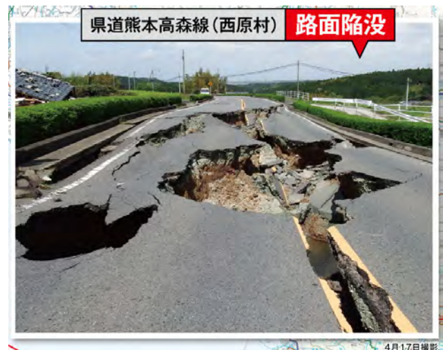
図 34 西原村の道路支障箇所
