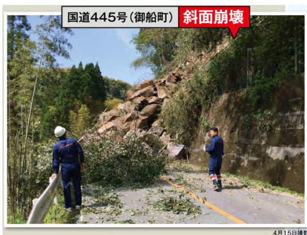
図 33 御船町の道路支障箇所
