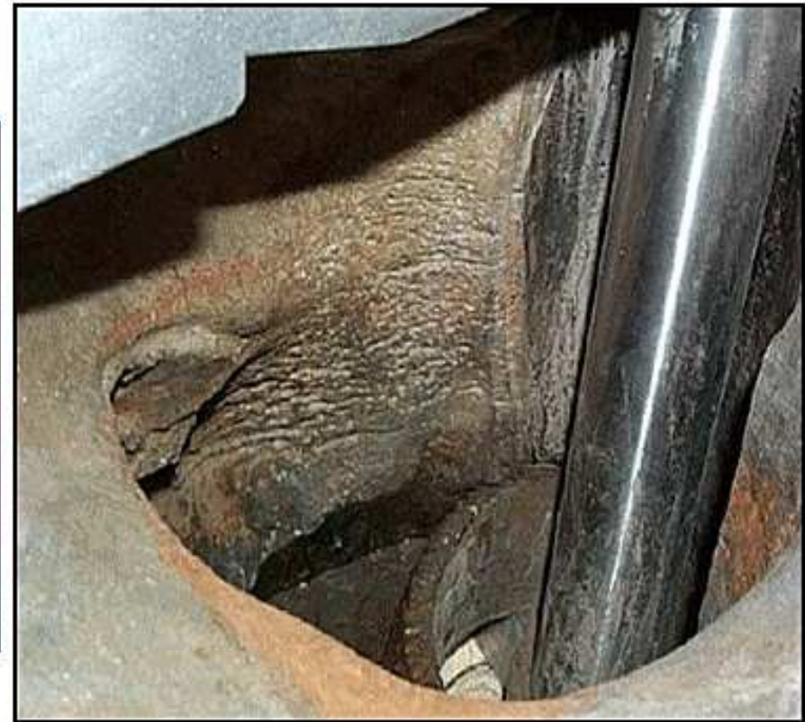
図6 原子炉容器上蓋に見つかった腐食劣化の状況(写真)
