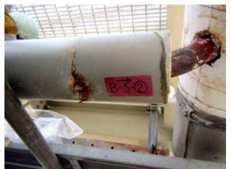
配管の外装板のサビ＝真ん中の縦に黒くなった箇所。この内側の配管に穴が開いた(九電資料)
